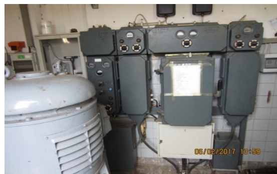
Siel und Schöpfwerk Landmarschengraben: Veraltete Elektrotechnik
