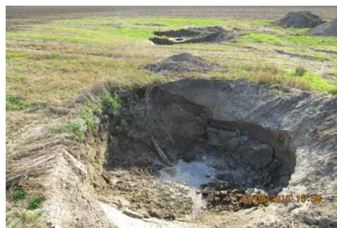
Verursachter Schaden durch defekte Rohrleitung auf landwirtschaftlicher Fläche.
