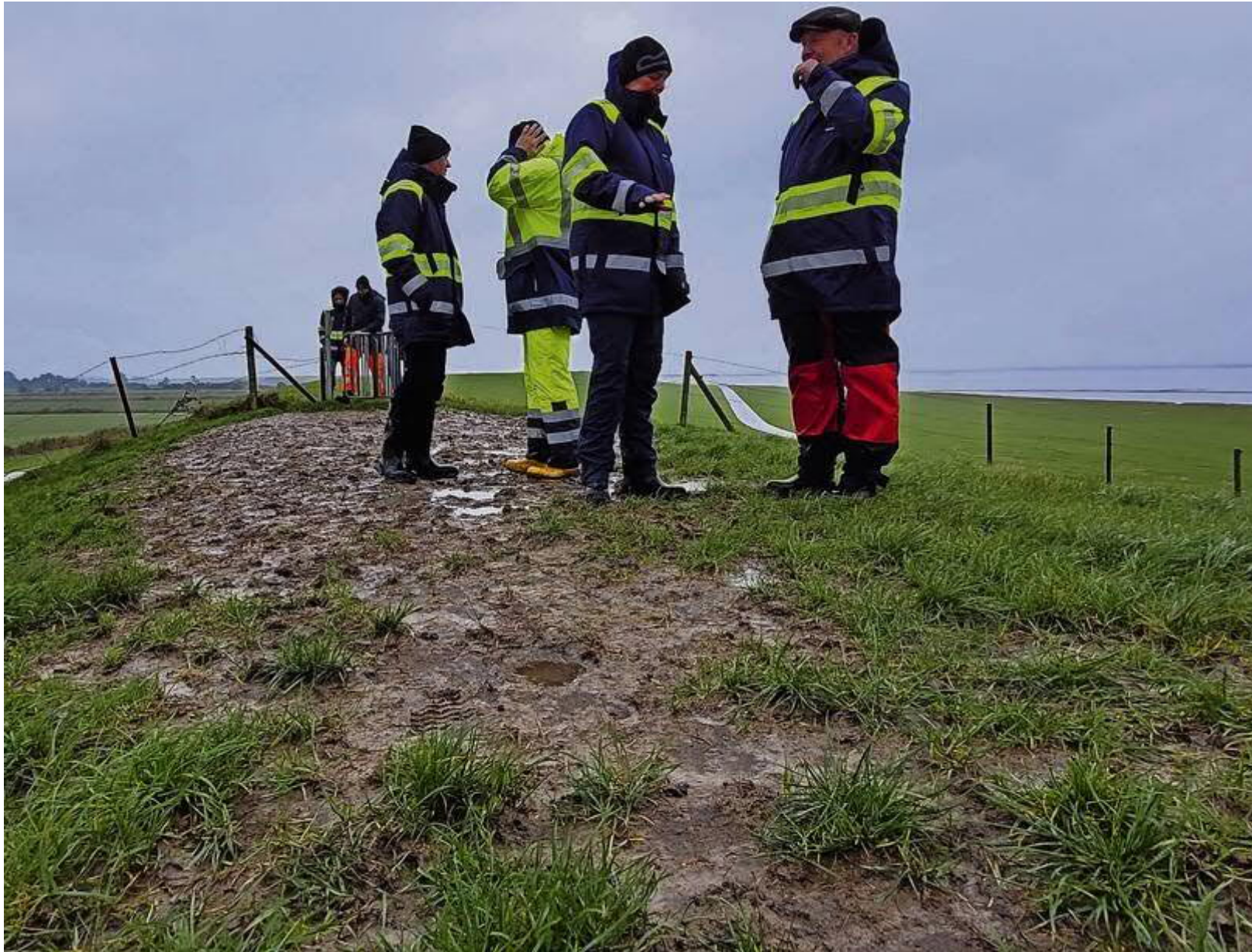
Niedergetretenes Gras wie hier auf der Deichkrone zwischen Wremen und Dorum-Neufeld veranlasst die Deichaufsichtsbehörde zur Kritik. Eine dichte Grasnarbe ist essenziell für die Stabilität des Deiches. Fotos: Leuschner
